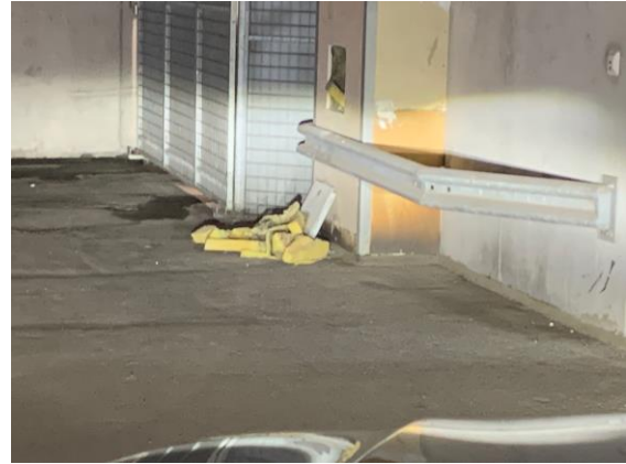
Uppbruten inspektionslucka i garaget, dec 2023
